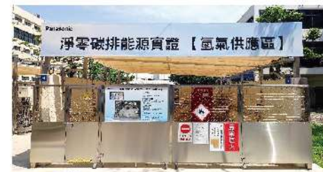
Panasonic 台灣淨零碳排能源實證場域 由 PV + 蓄電 + 氫燃料電池及能源管理系統溫水循環組合供給 (2024 年 4 月開始運行)
